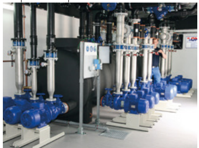
Vue d'un grand système de refroidissement de conteneurs se composant de plusieurs modules pour une entreprise de transformation des métaux.
