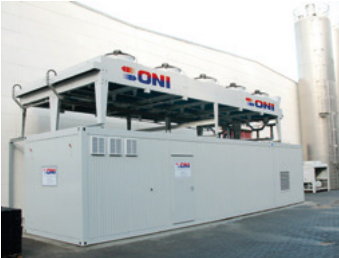
Module central d'un centre énergétique avec refroidisseurs sans glycol intégrés pour un système de refroidissement à deux circuits avec système de réduction de charge en hiver.
