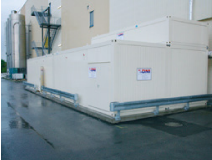
Vue d'un centre énergétique constitué de 5 modules pour plusieurs circuits de refroidissement pour un fabricant de papiers spéciaux.
